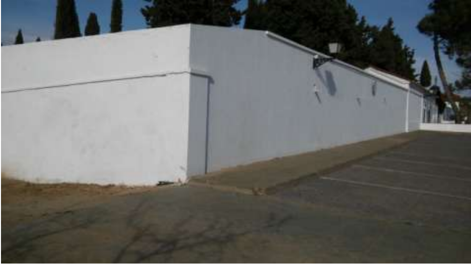
Foto 5: Vista de la esquina izquierda donde estaba ubicada la puerta de entrada al Cementerio Civil
